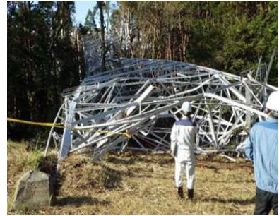
（写真）倒壊した鉄塔
