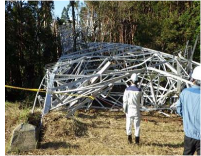
(写真) 倒壊した鉄塔
