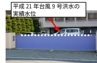
〔佐用中央病院〕浸水防止扉
