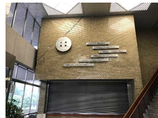
【茨木市役所内の壁ひび割れ】
