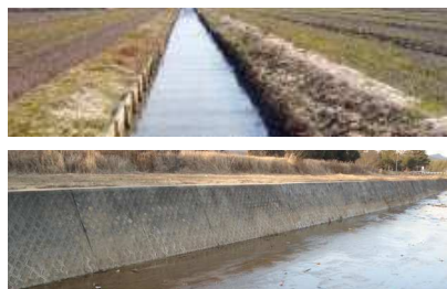
矩形水路・急勾配護岸による縦断連続性の喪失
