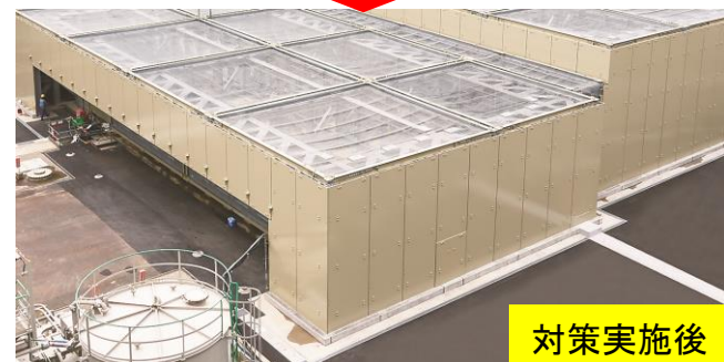
海水ポンプ室の竜巻飛来物防護対策設備の設置状況
