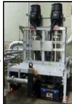
中圧ポンプ (1台/号機)
