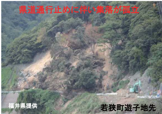
常神半島 法面崩壊発生状況
