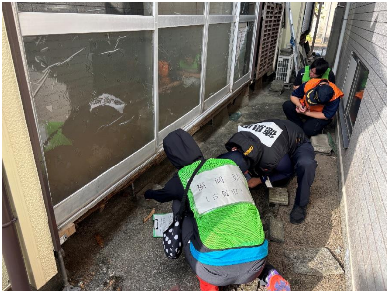
住家被害認定調査(徳島県)
