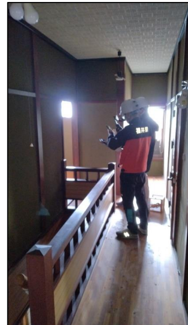
被害家屋調査(珠洲市宝立地区) 27
