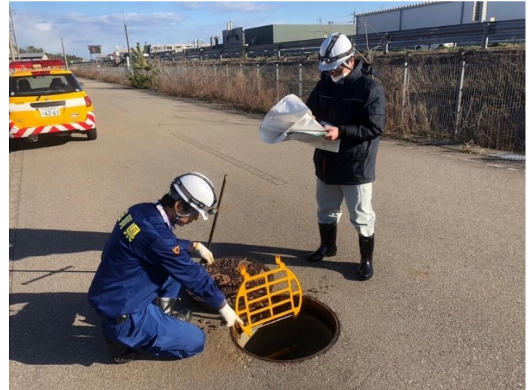
下水道管渠被害調査の様子
