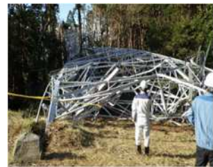
（写真）倒壊した鉄塔
