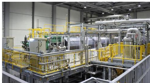
10MWの水電解装置
