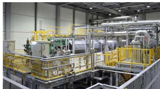
10MWの水電解装置
