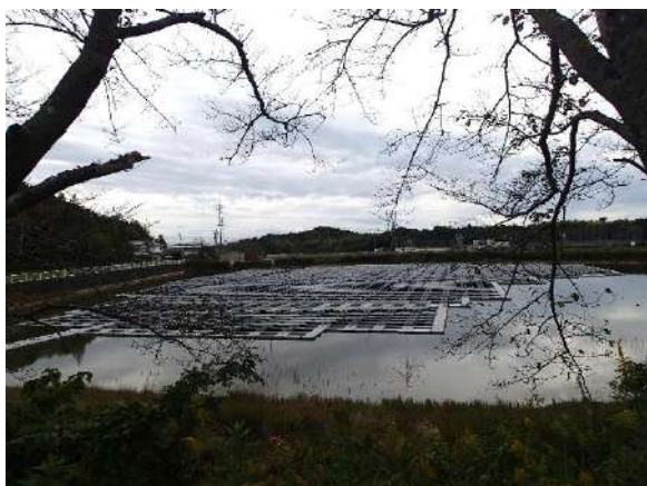
逆池に設置された太陽光パネル
