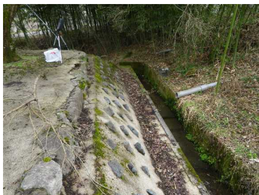
側溝や排水路
