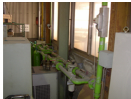
圧縮エネルギー流量計算システムによる エア流量の調整による使用電力の削減
